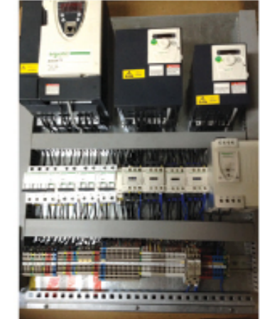
Electric Control Panel Panneau de Commande d'Electrique
