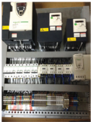
Electric Control Panel Panneau de Commande d'Electrique
