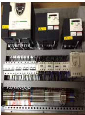
Electric Control Panel Panneau de Commande d'Electrique
