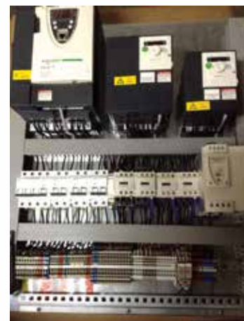
Electric Control Panel Panneau de Commande d'Electrique
